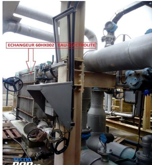
Figure 1. Échangeur 60HX002 de MMG Kinsevere
